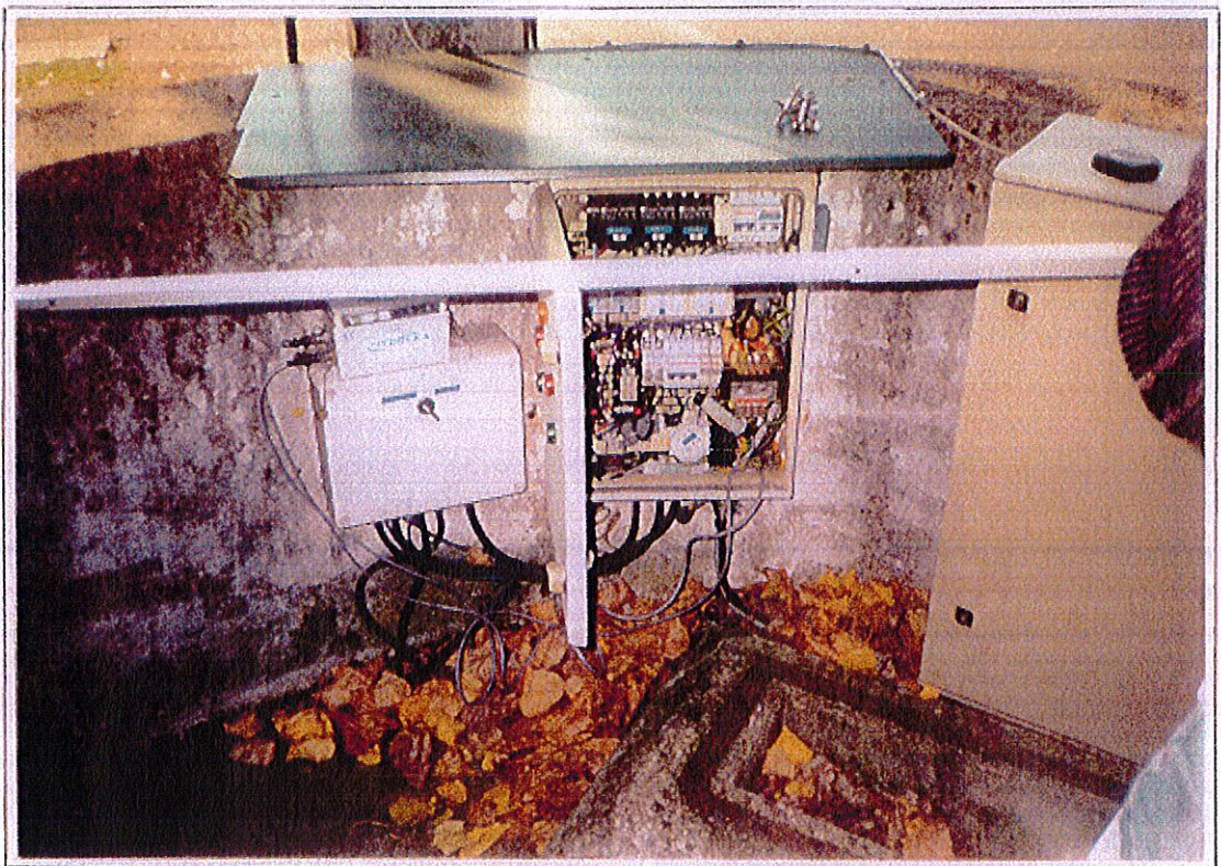
ARMOIRE ELECTRIQUE DU PR
