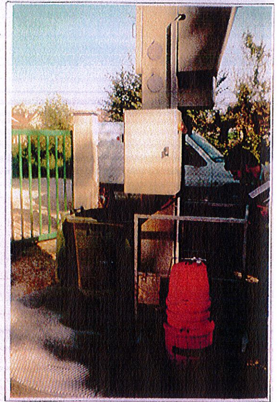
VUE EXTERIEURE AVEC CENTRALE D'ACQUISITION ET PRELEVEUR
